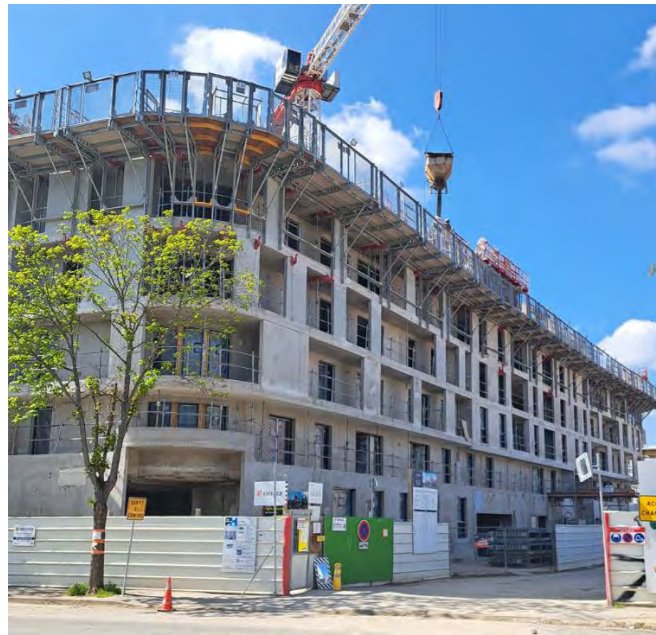
Le long de la rue Paul Hochart, La ZAC Paul Hochart en cours de réalisation
