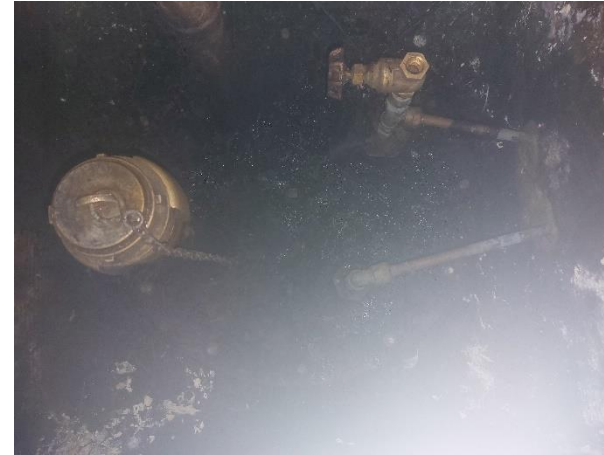
Cuve enterrée à fioul au droit de la parcelle
