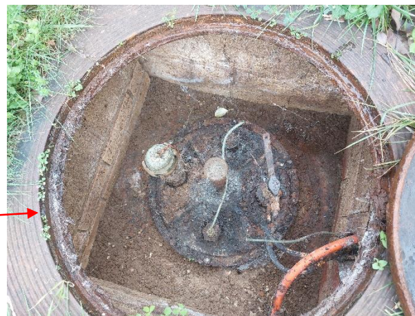
Cuve enterrée à fioul identifiée à l'arrière du pavillon
